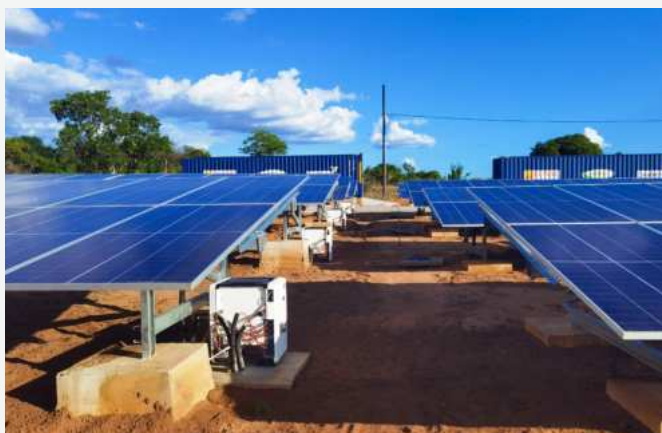
Central Fotovoltaica de Mugulama
