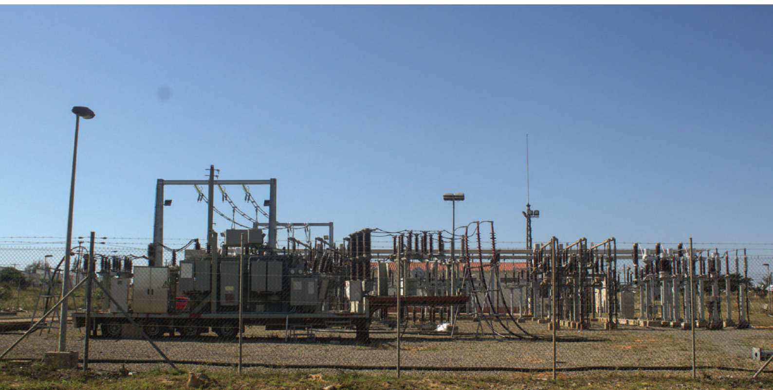
Subestação do Zimpeto - Cidade de Maputo
