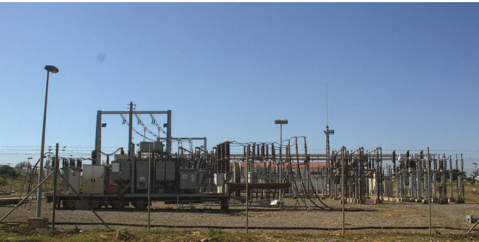
Subestação do Zimpeto - Cidade de Maputo
